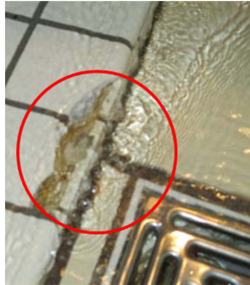
Ausbrüche an Fliesen
