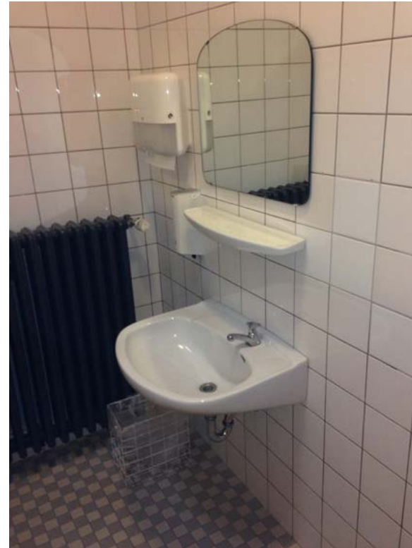
In die Jahre gekommene Sanitärobjekte und mehrfach geflickte Fliesen im Wandbereich
