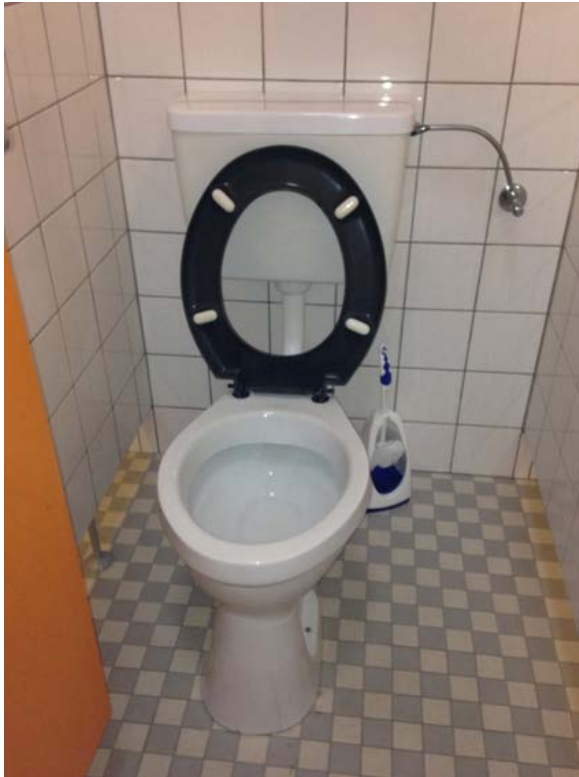
Alte Tiefspülstandtoiletten mit Vorsatzspülkästen
