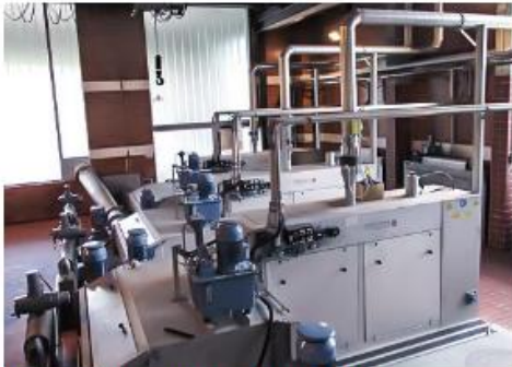
Erweiterung der Rechananlage auf der HKA Münster
